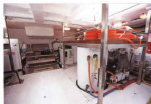
アフト左舷側にはポンプ類が装備されている。もちろんこちらもすべてダブルで装備されている。
